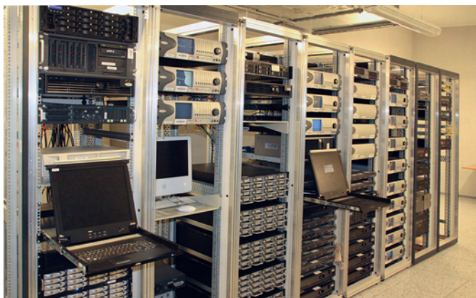
Bild 6. ISIS-Gestelle im zentralen Maschinenraum
